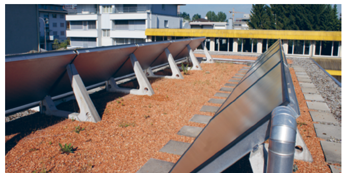
Collettori solari montati su rialzi in cemento. Le piastre per camminamenti proteggono il sistema di impermeabilizzazione per i lavori di manutenzione e riparazione sui collettori.
